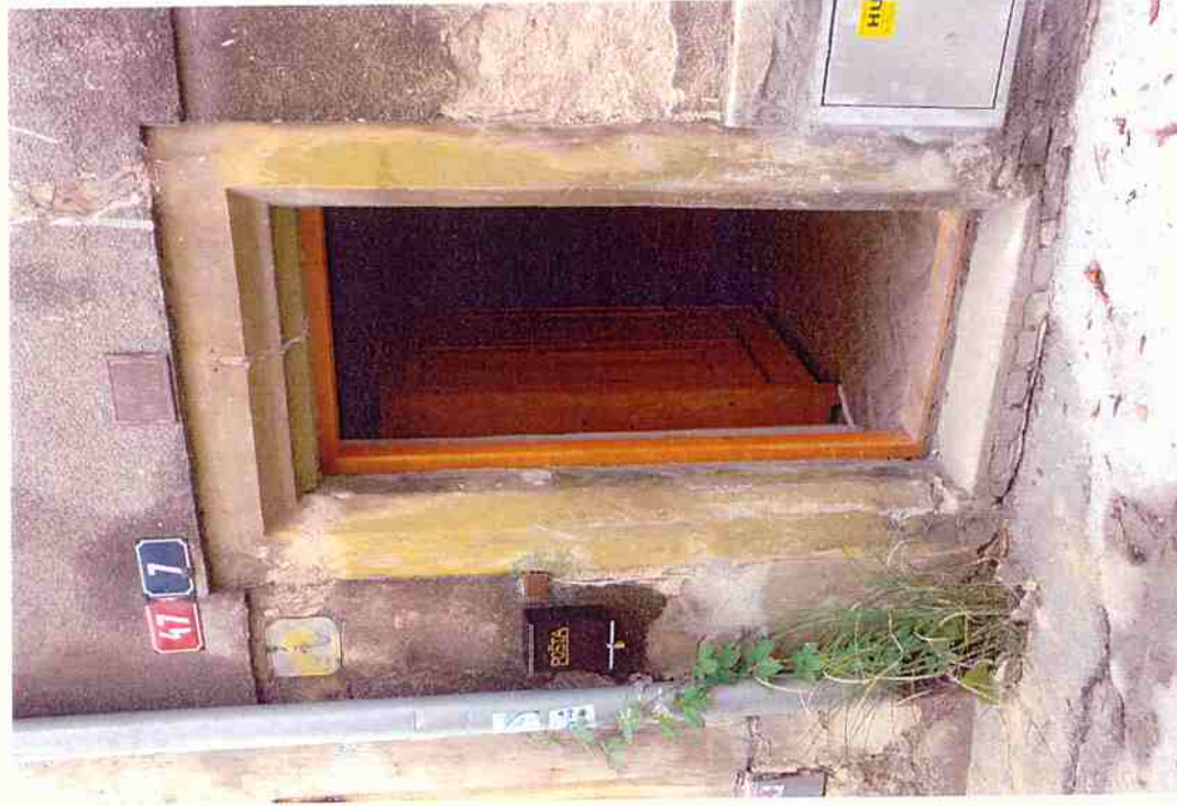
Stav před restaurováním
