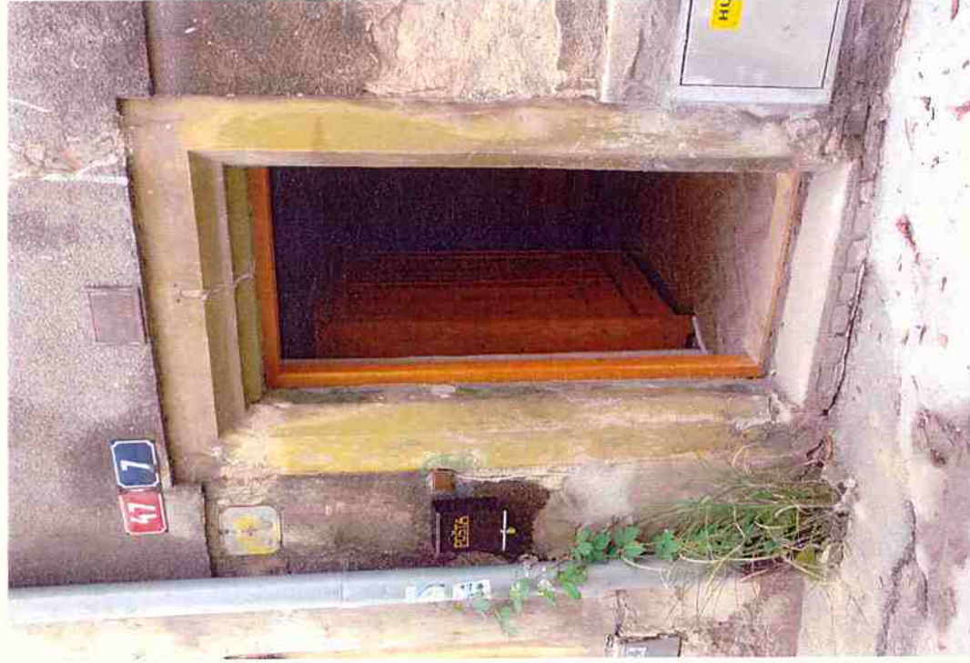
Stav před restaurováním
