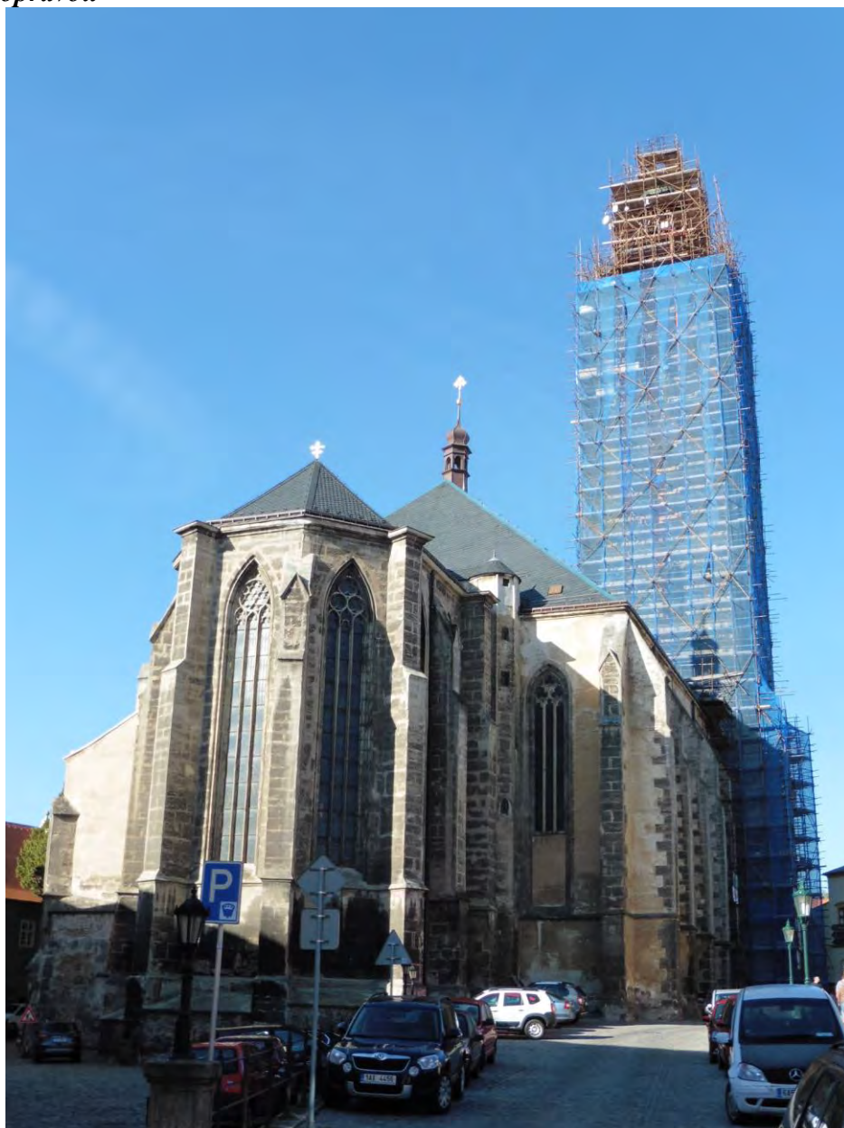
Stav před opravou
