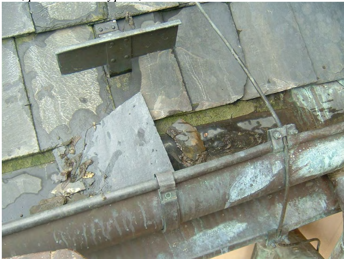
Severozápadní křídlo – detaily poškození
