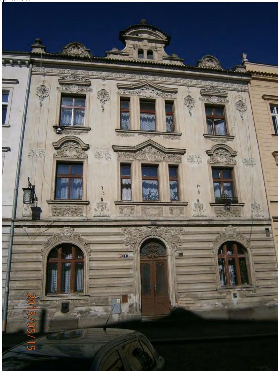
Stav před opravou
