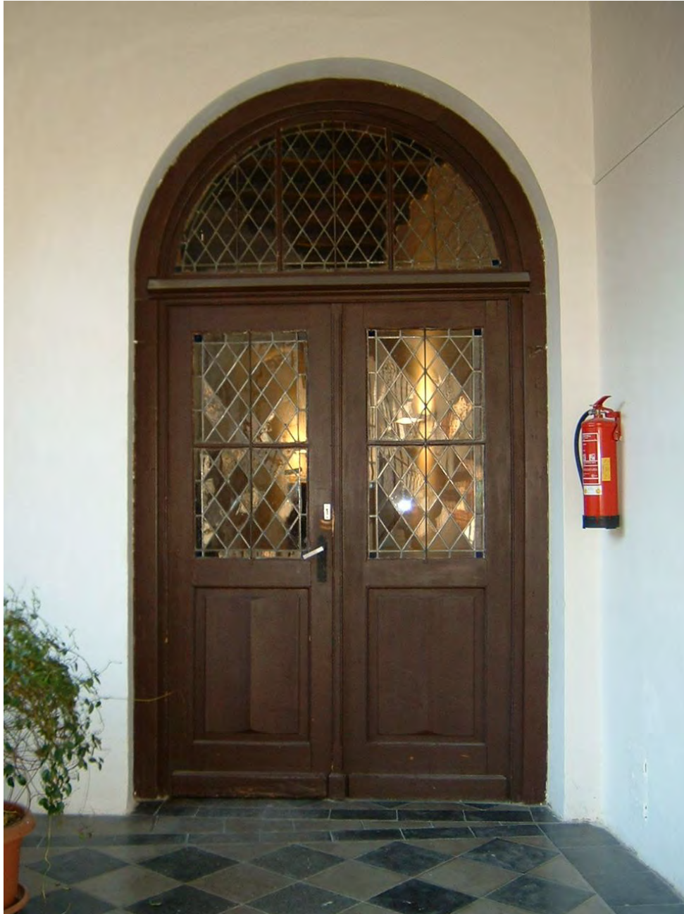
Stav před restaurováním
