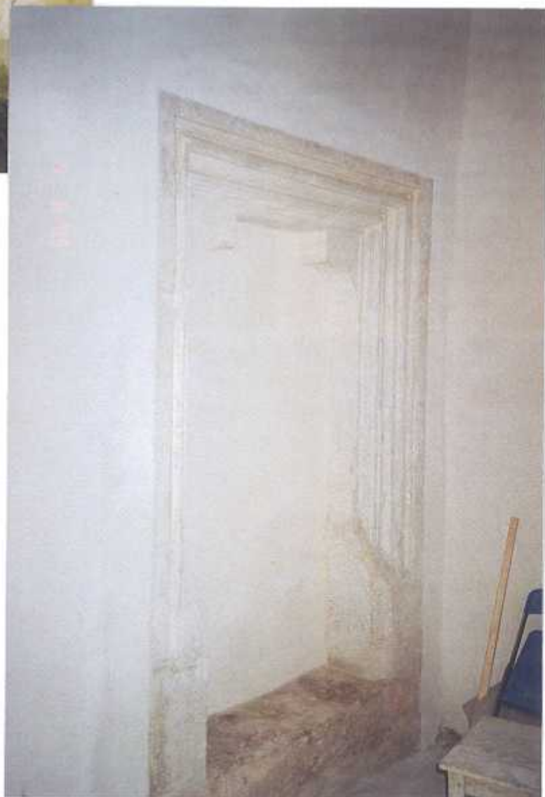
Čp. 34 Barborská ulice, Kutná Hora Kamenný portál v I.patře objektu – průběh restaurování a stav po restaurování
