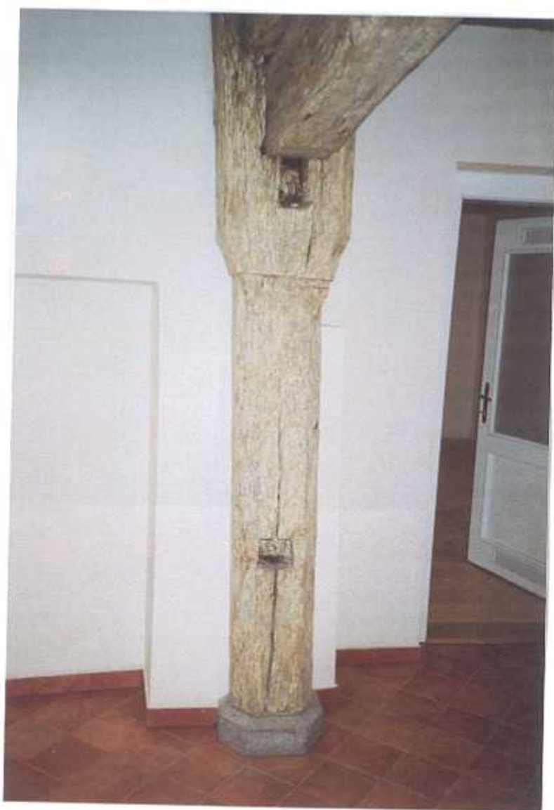
Čp. 34 Barborská ulice, Kutná Hora Dřevěný sloup trámového průvlastu v přízemí – stav po obnově
