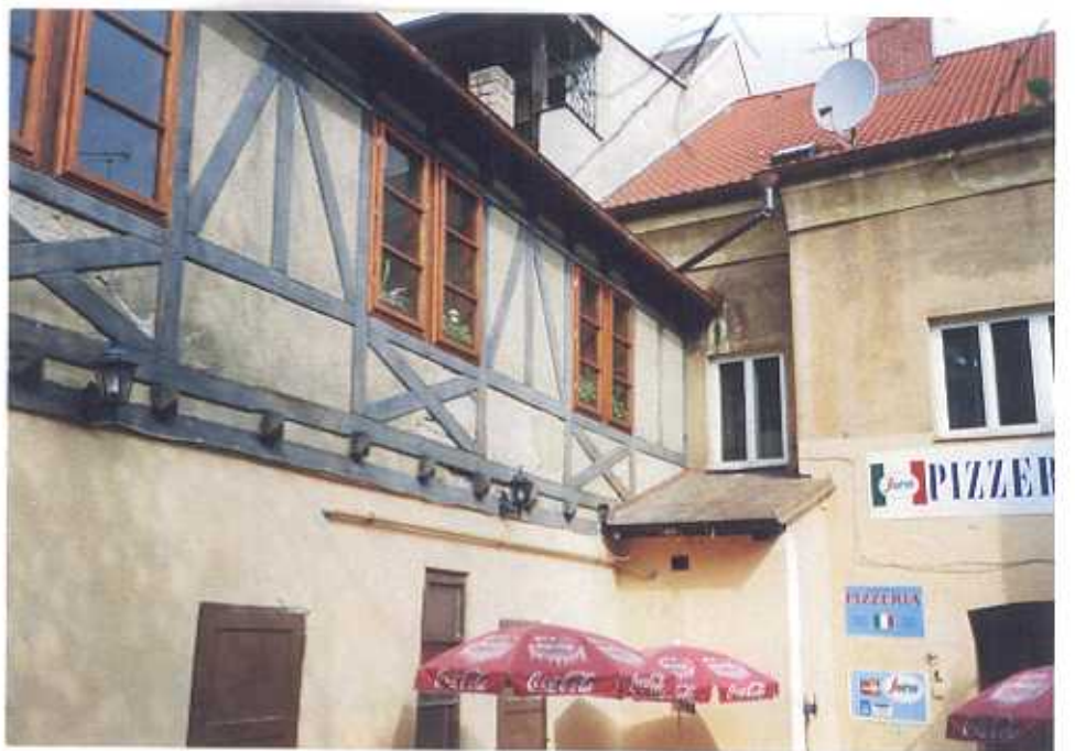
Čp. 90 Palackého náměstí, Kutná Hora Stav fasády před obnovou
