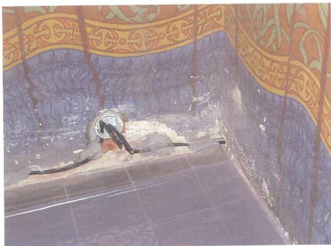
Stav před restaurováním
