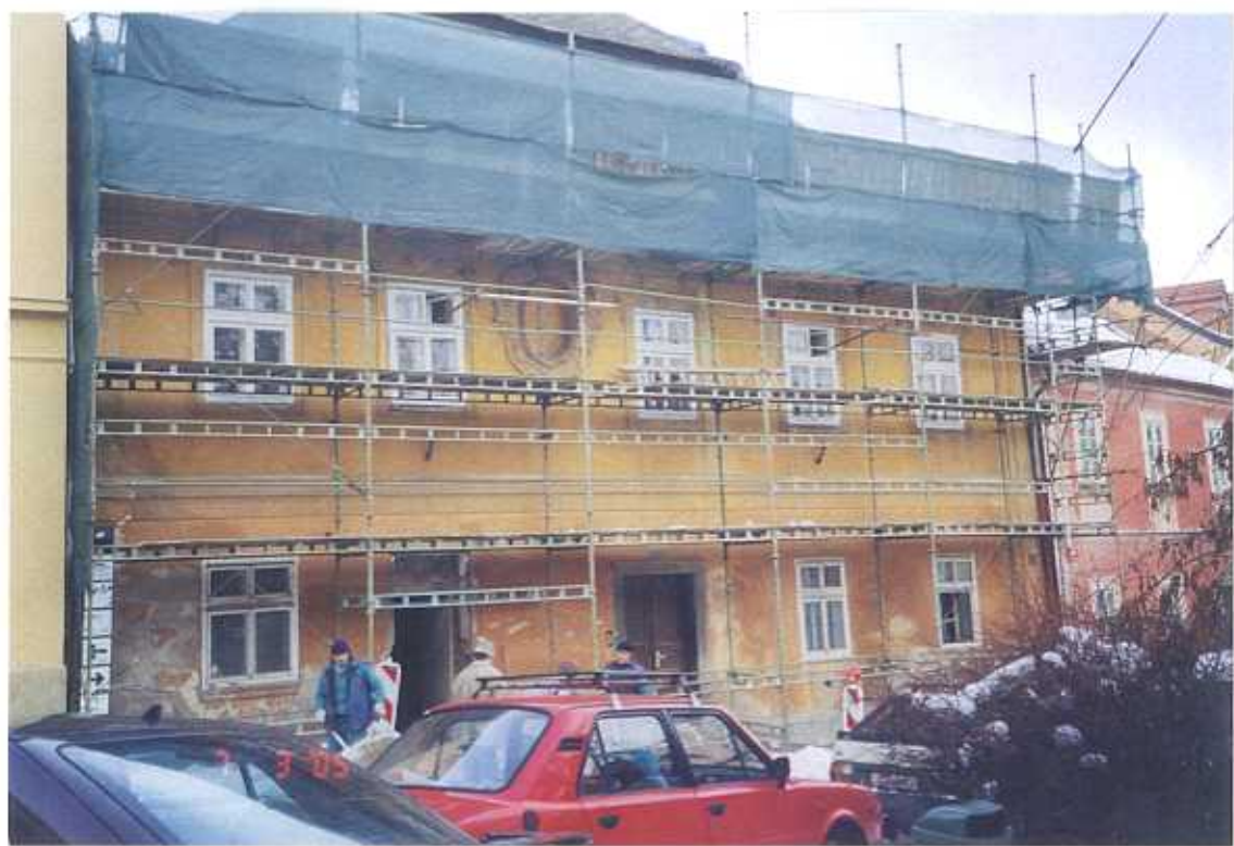
Čp. 34 Barborská ulice, Kutná Hora Stav fasády před obnovou
