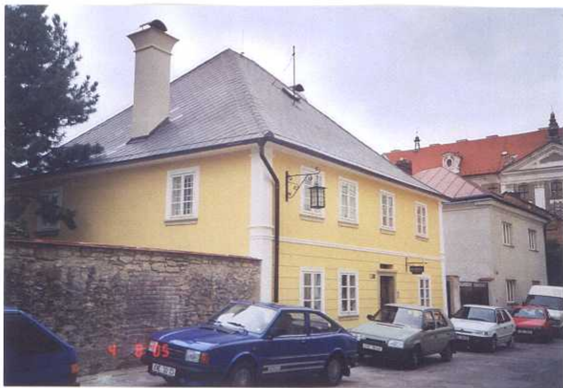
Čp. 300 Andělská ulice, Kutná Hora Stav fasády před obnovou a po obnově
