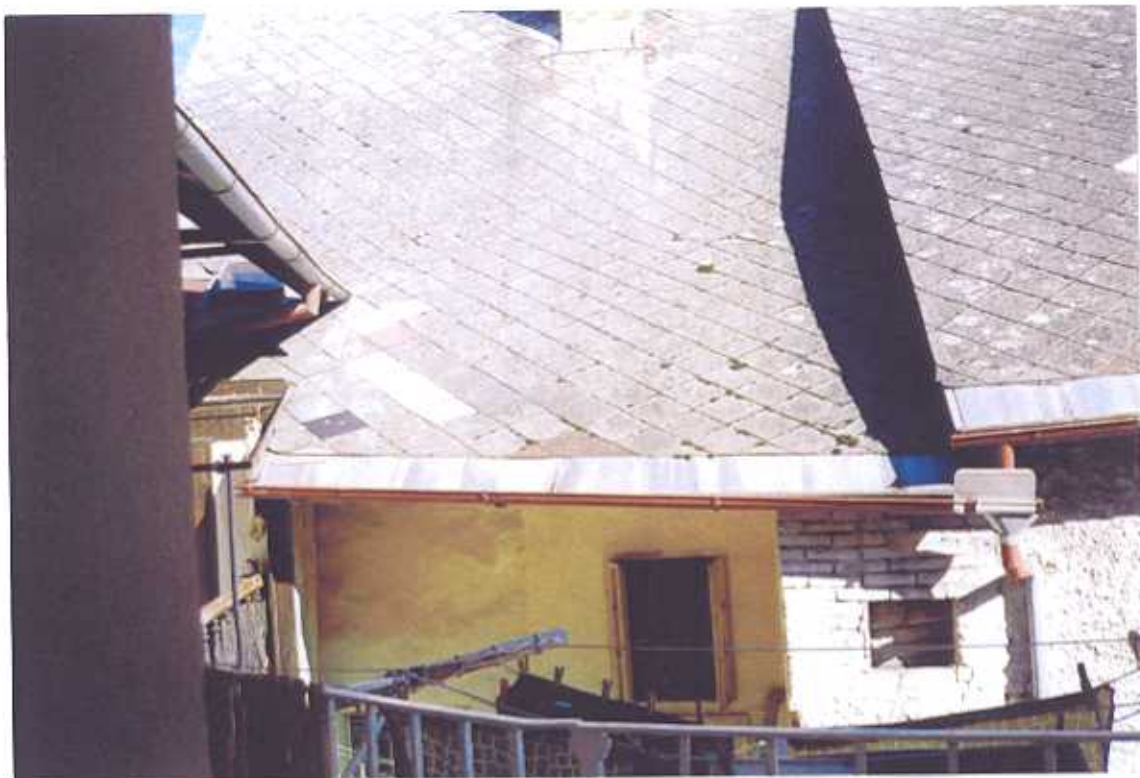
Dům čp. 18. Dačického náměstí, Kutná Hora stav střechy před zahájením obnovy
