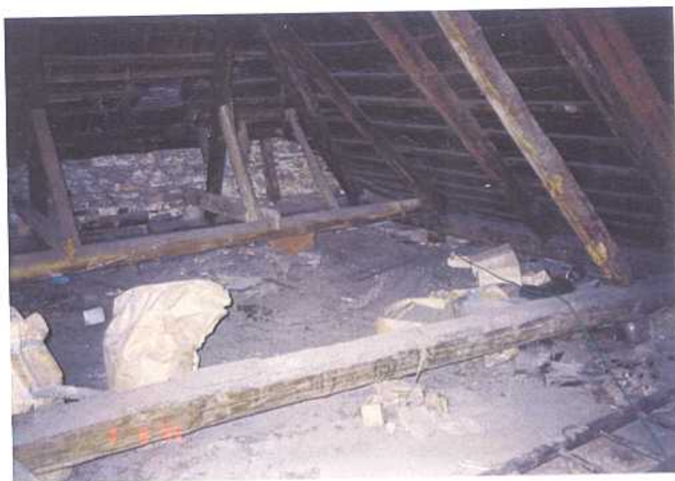
Stav krovu a podlahy půdy před zahájením opravy
