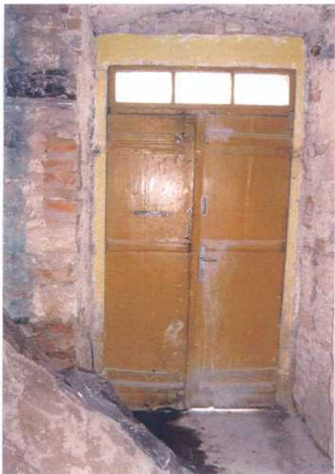
Vstupní dveře Česká ulice čp. 191 stav před restaurováním
