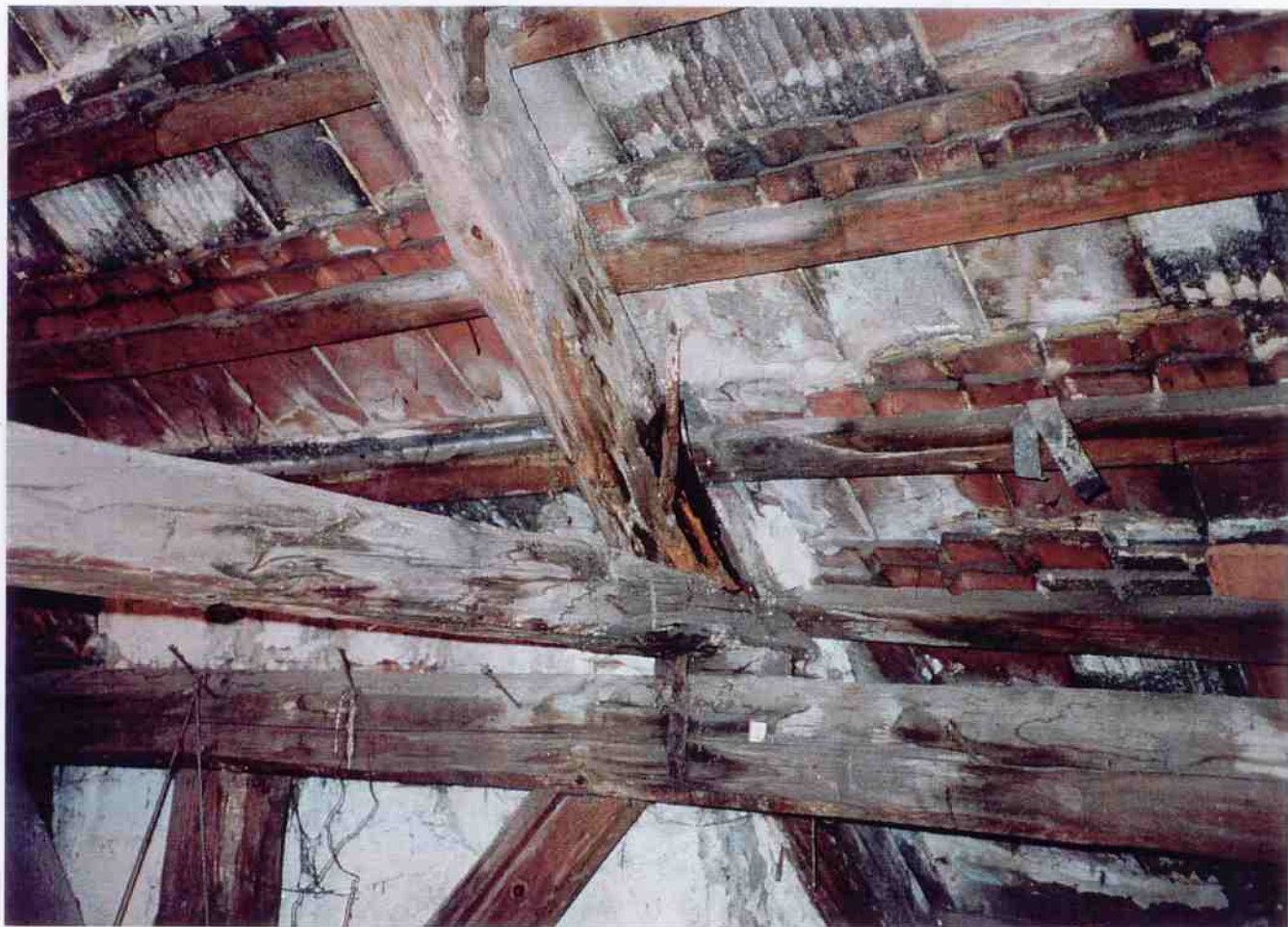
ČP. 362, SEDLECKÁ ULICE STAV PŘED OBNOVOU STŘECHY
