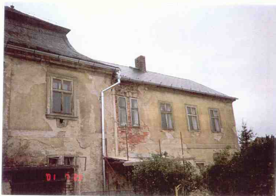
ČP. 2, ČESKÁ ULICE STATICKE ZAJIŠTĚNÍ DOMU
