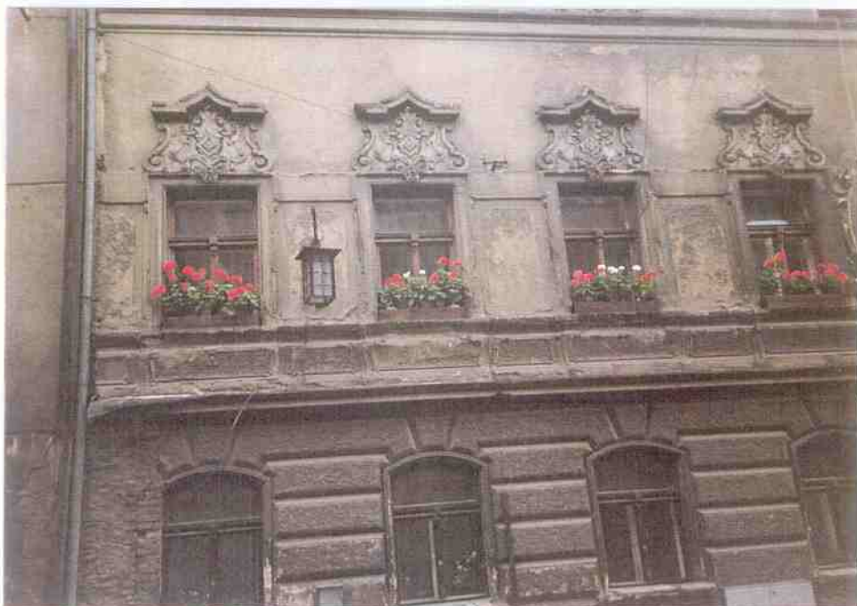
ČP. 333, VLADISLAVOVA ULICE STAV PŘED OBNOVOU STŘECHY
