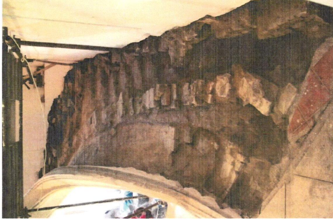
Konstrukce schodiště po rozkrytí stupňů a násypů. / The staircase construction after uncovering of steps and filings.
